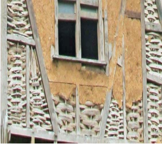
Fotoğraf 5: Ahşap karkas yapının çiteme dolgulu dış duvarı (Yığılca İlçesi, Kırık Köyü)
