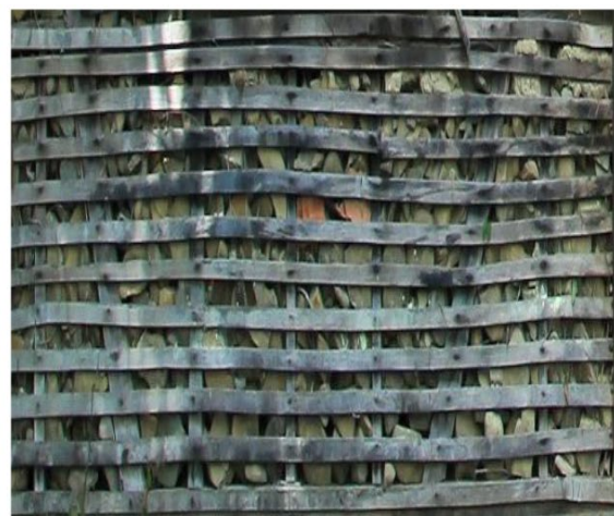
Fotoğraf 4: Ahşap karkas yapının taş dolgulu dış duvarı (Gümüşova İlçesi, Dere Köyü)
