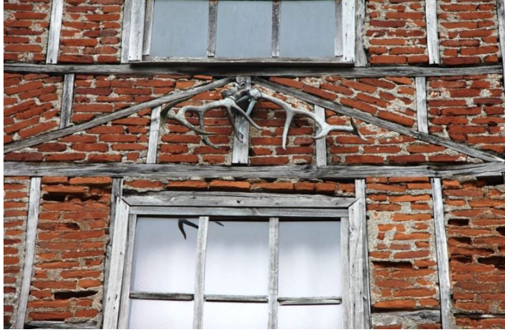
Fotoğraf 61: Geleneksel konutun pencere alınlığına asılan hayvan boynuzu (Akçakoca İlçesi, Yukarı Mahalle)
